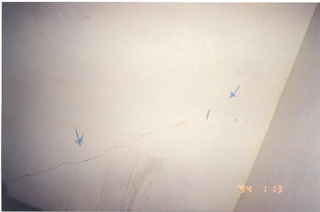
Foto 10 - Visão das trincas
